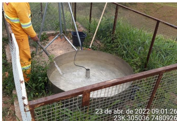
Foto 6 – Tanque do reservatório preenchido com água limpa. (Data: 23/04/2022).
