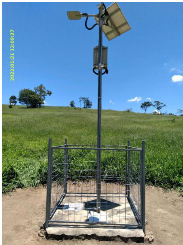
Estação Telemétrica Limpa (perto)
