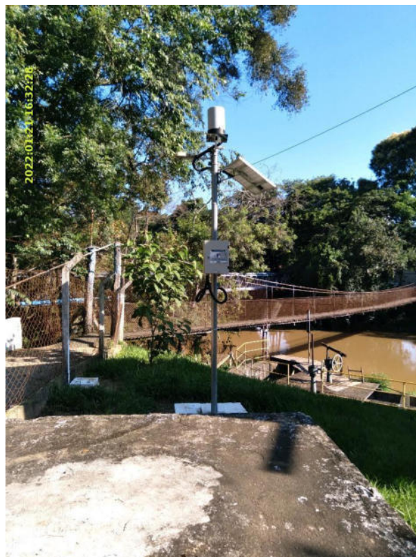
Estação Telemétrica Limpa (longe)
