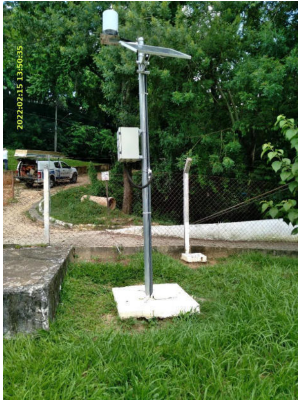
Estação Telemétrica Limpa (perto)
