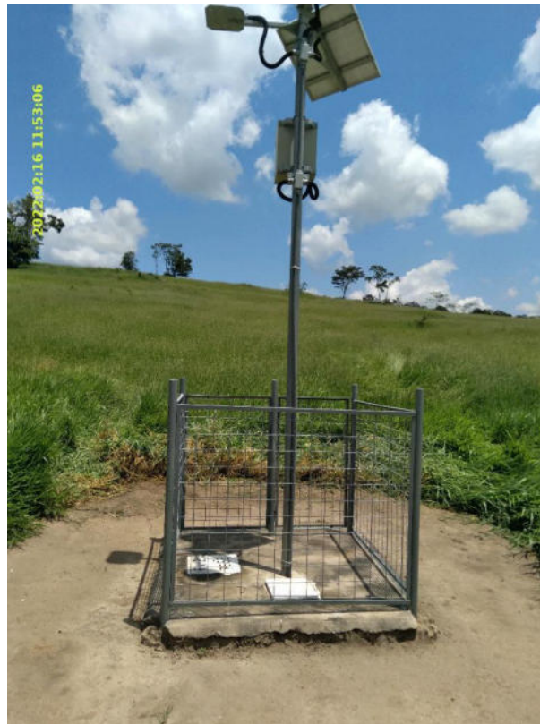
Estação Telemétrica Limpa (perto)
