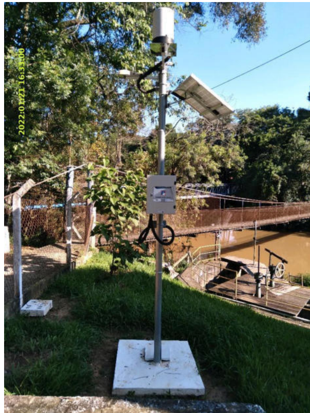
Estação Telemétrica Limpa (perto)
