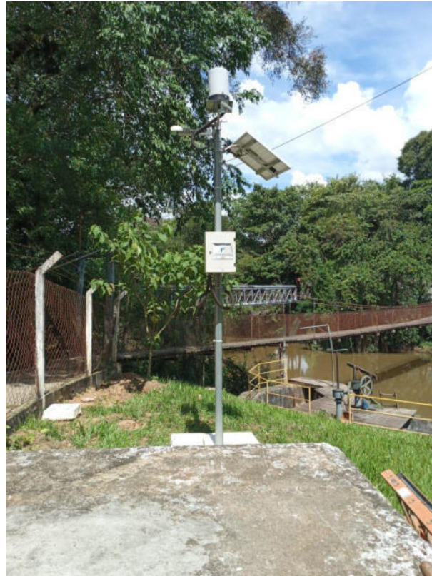
Estação Telemétrica Limpa (perto)
