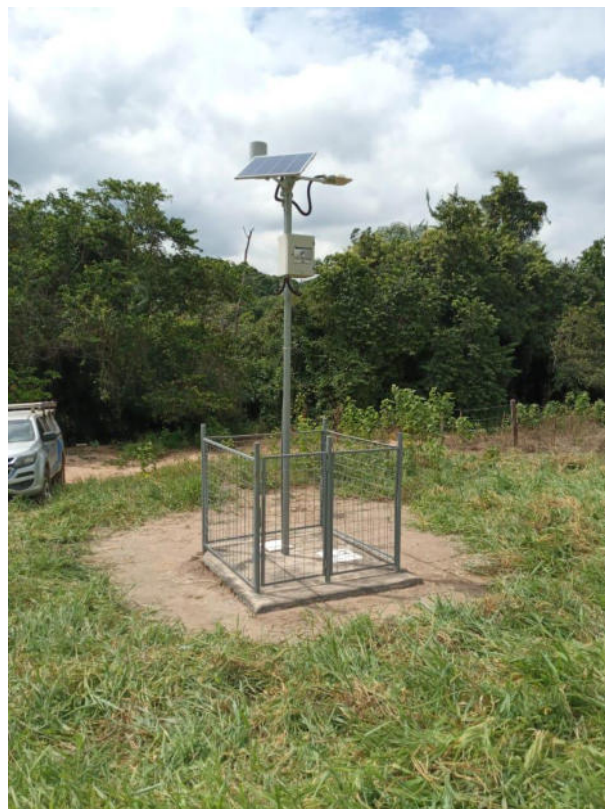
Estação Telemétrica Limpa (longe)
