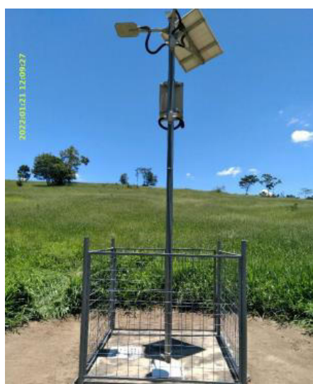
Foto 1 – Estação Hidrométrica Automática no PHM (Data: 21/01/2022).
