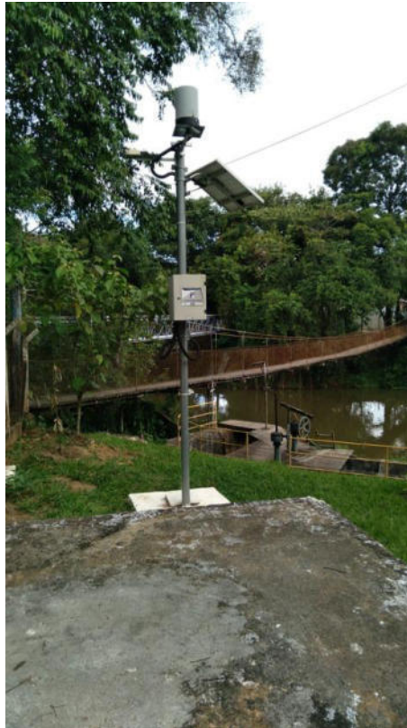
Estação Telemétrica Limpa (perto)
