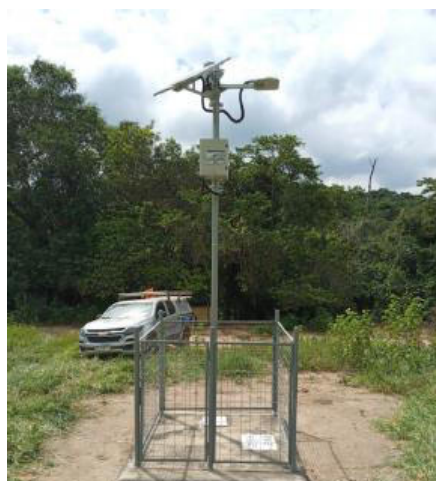
Foto 5 – Estação Hidrométrica Automática no PHM (Data: 28/03/2022).
