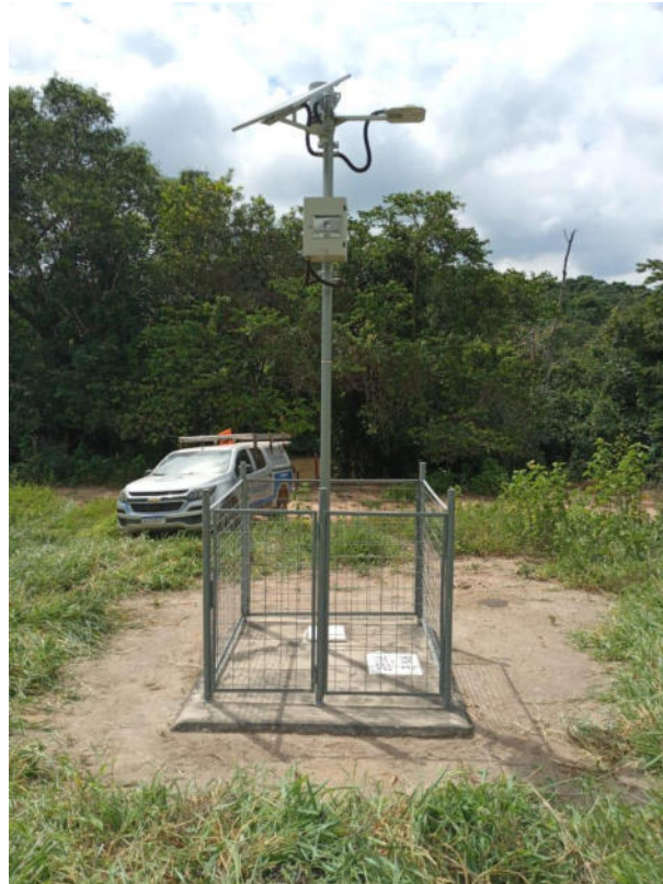
Estação Telemétrica Limpa (perto)
